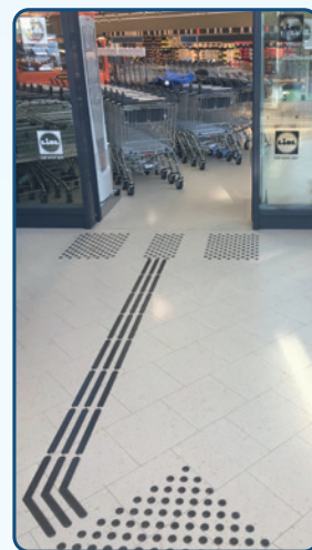
Blindenleitsystem und barrierefreier ebener Zugang mit Automattür (Lidl)
